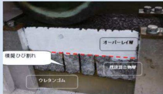
ひび割れ貫通
